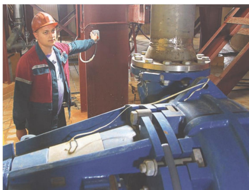
Машинист насосных установок Р.В.Шагун осуществляет запуск насоса.
